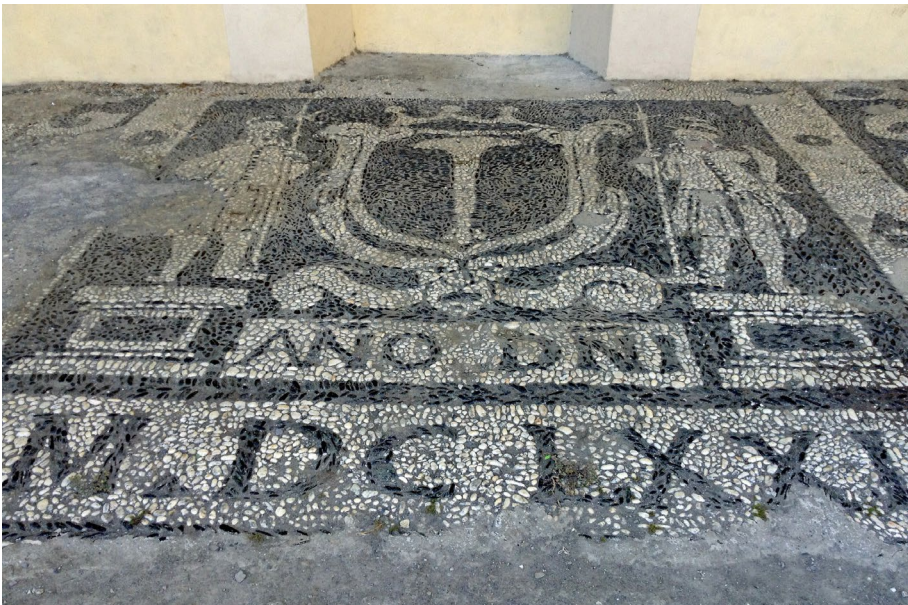
Fig. 8. Quadrante 22 prima del restauro.
