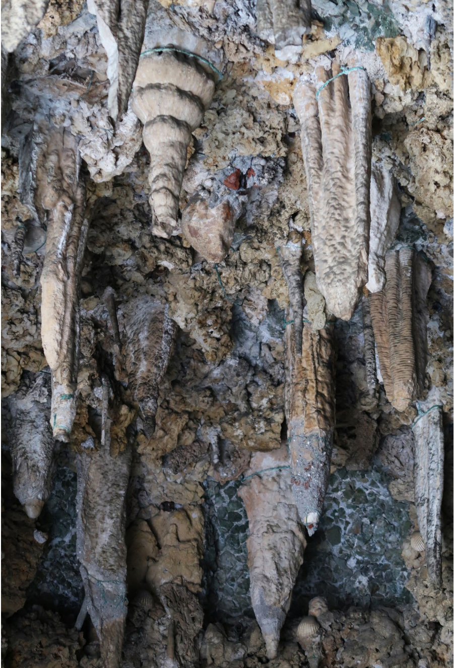
Fig. 6. Elementi per l'ancoraggio degli speleotemi al soffitto nella parte rustica: fili metallici e resti di malta con frammenti di terracotta (©MiC, OPD).
