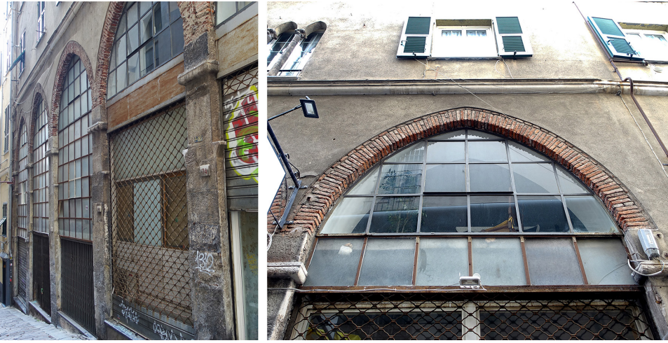
Fig. 13. Loggia angolare in salita all'Arcivescovato con archi a sesto acuto in mattoni su mensole in pietra.
